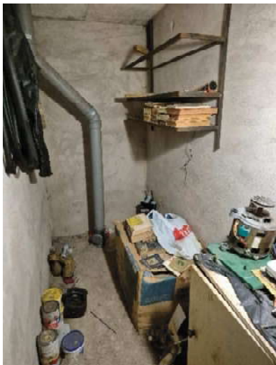
Siltummezgls (telpa Nr. 4 telpu grupa 015)
